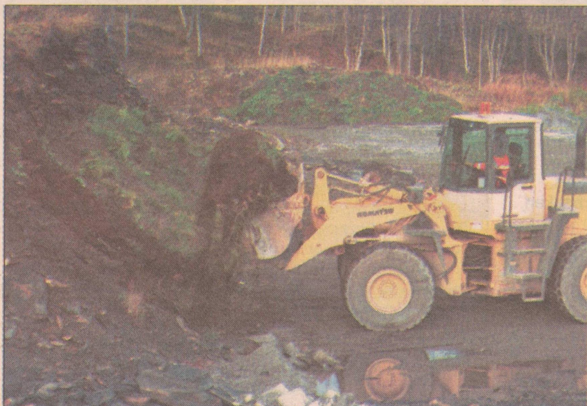
LANDSKAP MED GRAVEMASKINER: Bulldoserne må regne med å fjerne mellom 60 og 70.000 kubikkmeter løsmasse og fjell før Teorifagbygget står klart.
