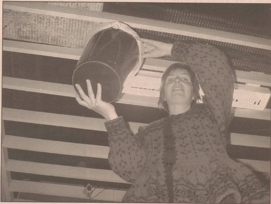
LEKKER: Ingeniørstudentenes bygg lekker. Undervisningsleder Liv Cecilie Ekjord Elvestad har opplevd at bøtter og spann må frem for å ta i mot vannet fra oven.
