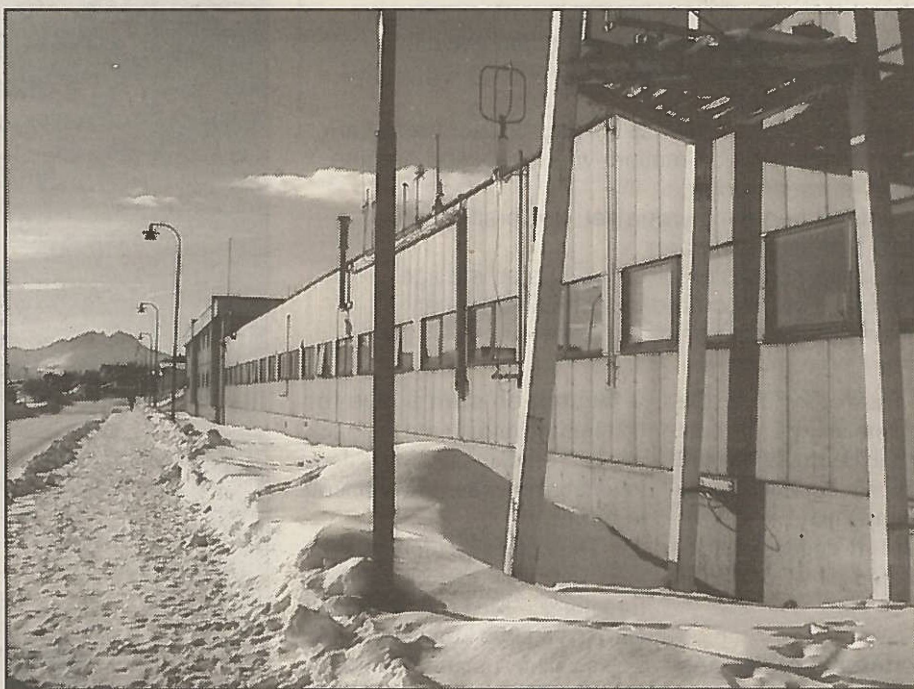
DÅRLIG BYGG: Studentene i økonomi og administrasjon ved HiTø gir undervisningslokalene sine strykkarakterer. Foto JON TERJE EITERÅ
