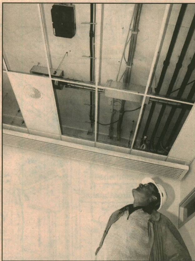
TEKNOLOGI: Prosjektleder Kjell Jensen i Statsbygg titter opp på en liten del av Teorifagbyggets kontrollsystemer.
