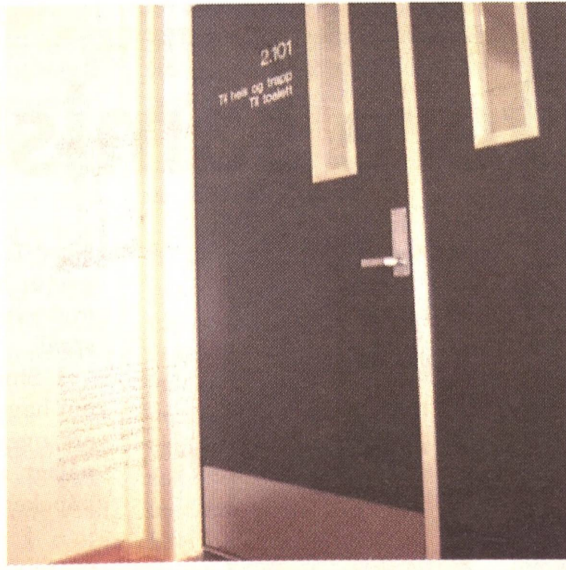
TUNG DØR: Denne døra er svært tung og mangler døråpner på innsiden.
