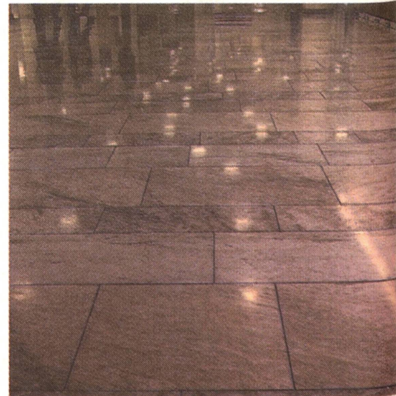
GLATT GULV: Dette marmorgulvet er svært glatt.
