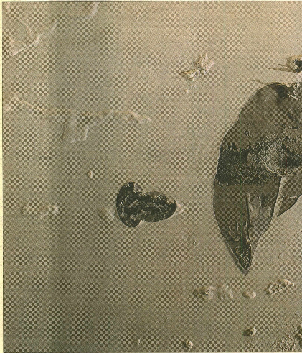
FUKTSKADET: Teorifagsbygget er hjemsoekt av vann- og fuktskader. Her et en sterkt fuktskadet vegg utenfor Akademisk Kvarter.
